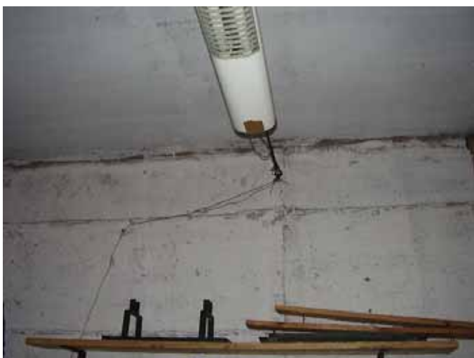
Beispiel eines unsachgemäß verlegten Stromkabels.
