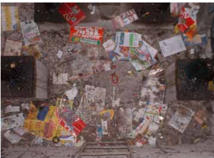
Blick in einen Aufzugsschacht mit viel Müll!
