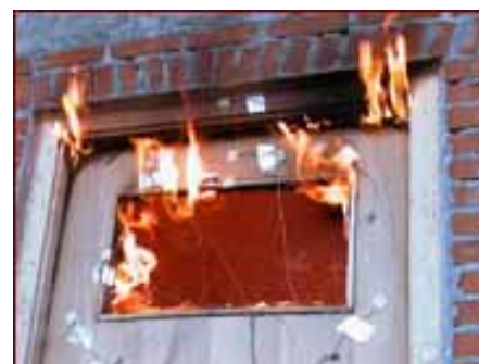
Beispiel eines Brandes an einer Brandschutztüre
